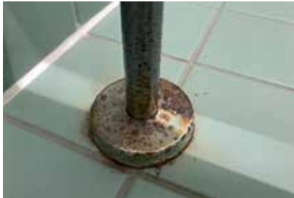
Stützenfuss, Duschrinne, Halteschale mit Korrosionserscheinungen.
